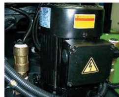
冷却液箱电机 停止改为关闭
